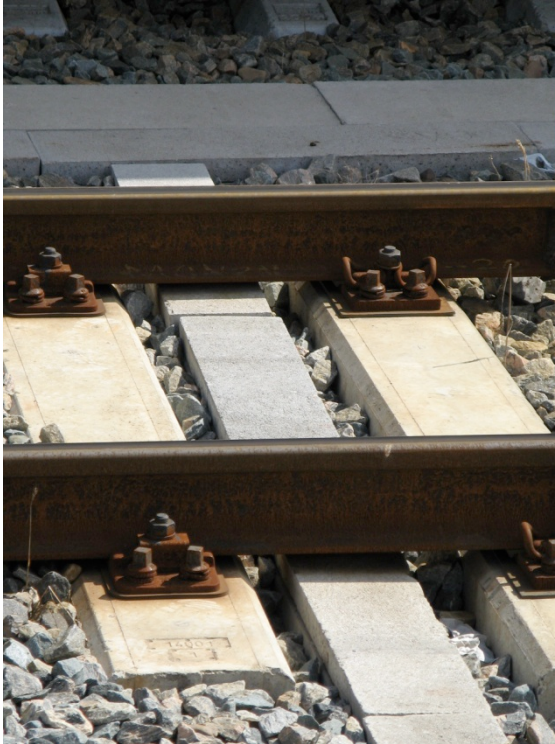
Foto 1 - gangbare situatie met kabelkoker tussen de dwarsliggers in.
